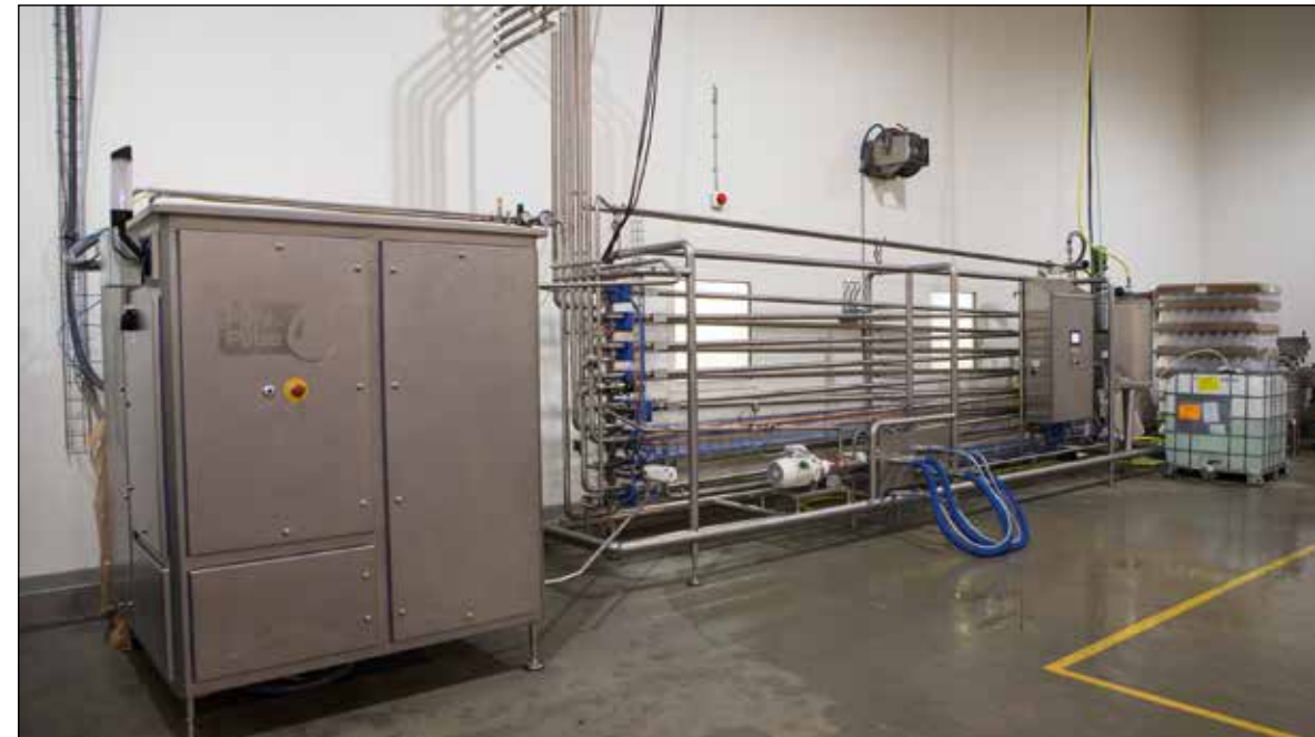
De pasteurisatie met elektrische pulsen vindt plaats in de metalen kast links. Alle leidingen rechts dienen om de vruchtensappen op te warmen tot 40 graden Celsius, de temperatuur waarbij de pasteurisatie in de kast plaatsvindt.
