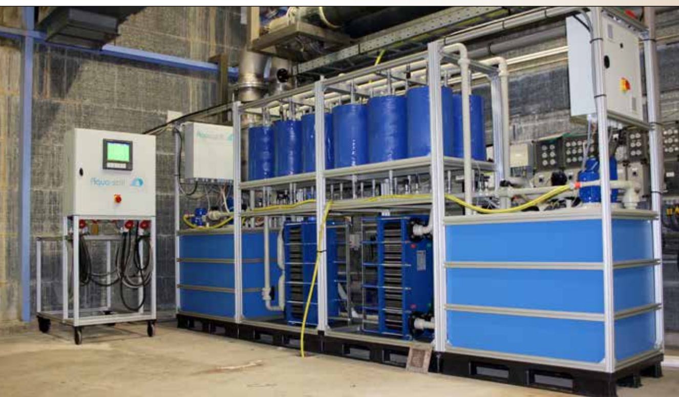
Installatie met twaalf parallel geschakelde membraanmodules, die met behulp van membraandestillatie bij lage temperaturen demi-water uit oppervlaktewater maakt.
